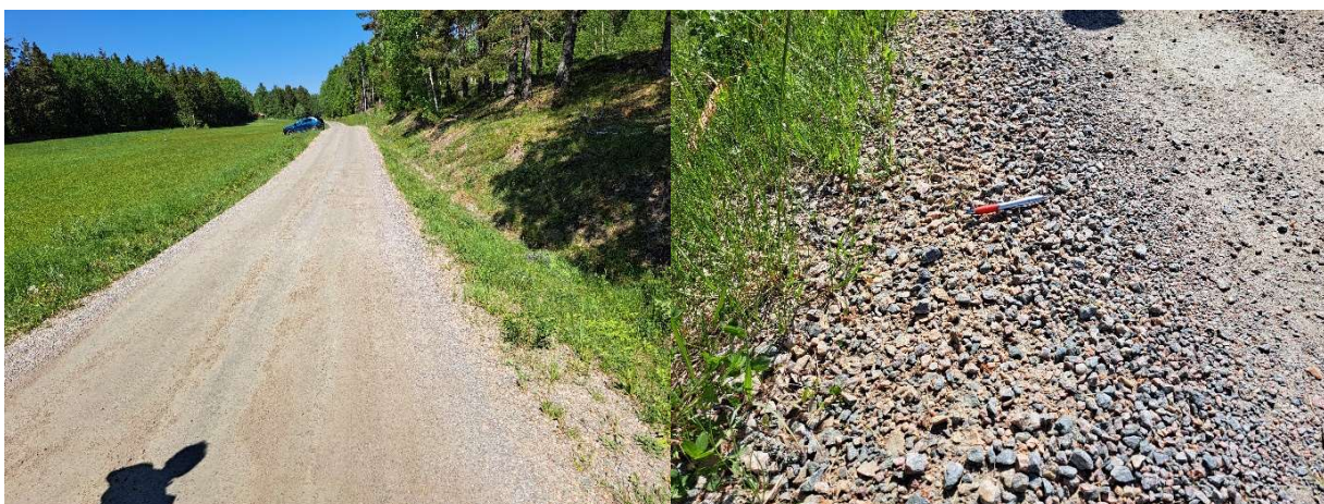
Figur 28. Sträcka 1, material A 0/16. Till vänster potthål i höger hjulspår. Till höger "gult" grus i väggkant.
